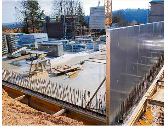
Die Schalttafeln für den Neubau der Sporthalle der Questenberg-Grundschule haben eine Höhe von 8,40 Meter.
