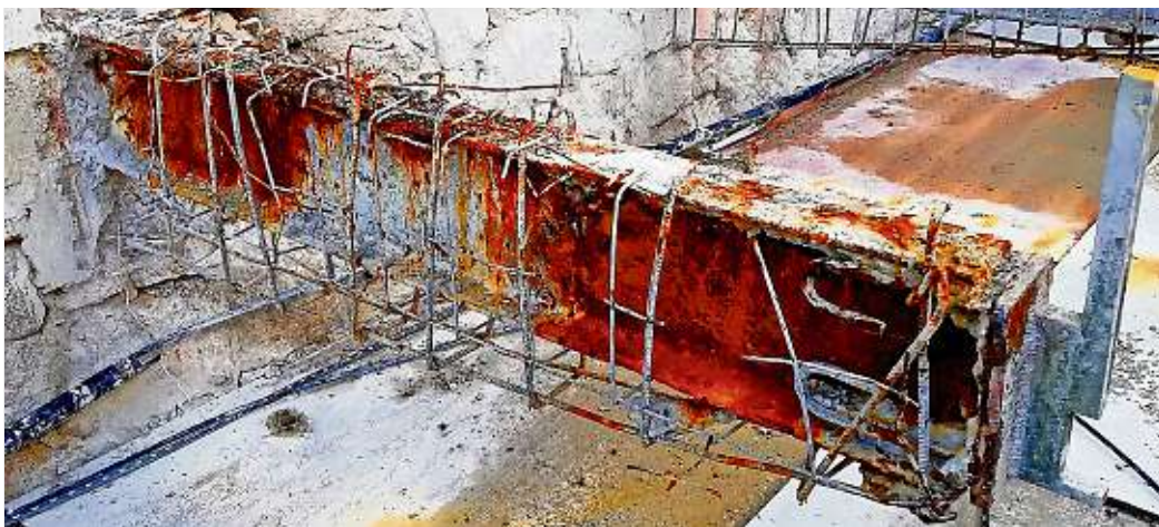
Beschädigter Stahlträger am Triebischsteg
