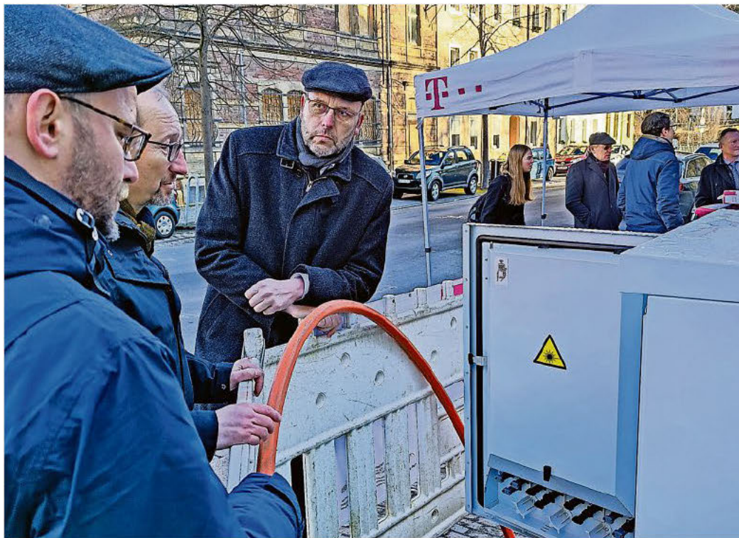
Fachreferent Thomas Irrgang (Mitte) erläutert Wirtschaftsförderer Martin Schuster und Oberbürgermeister Olaf Raschke die Vorgehensweise bei der Verlegung der Glasfaserkabel.
